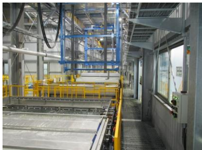
Ligne d'anodisation semi-automatique propre
